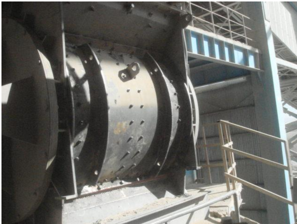
تصویر ۵- تصویر اجرا شده طرح بر روی روتاری معیوب و بکارگیری مجدد تجهیز
